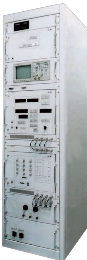
精測レーダー受信装置
